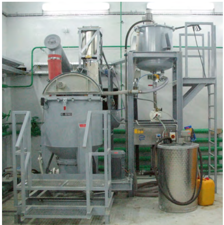
Abb. 9 Zementierungsanlage. Foto: NUKEM Technologies
